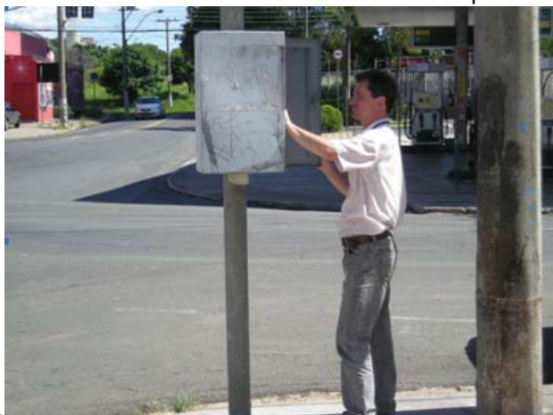
Acesso ao controlador semafórico em campo
